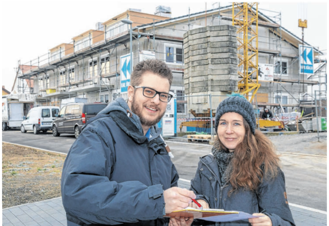
Carolin und Holger Morlok vor dem Rohbau ihres Zeitwohnhaus mit 13 Appartements, das sie in Neckarwestheim errichten. Foto: Helmut Pangerl
