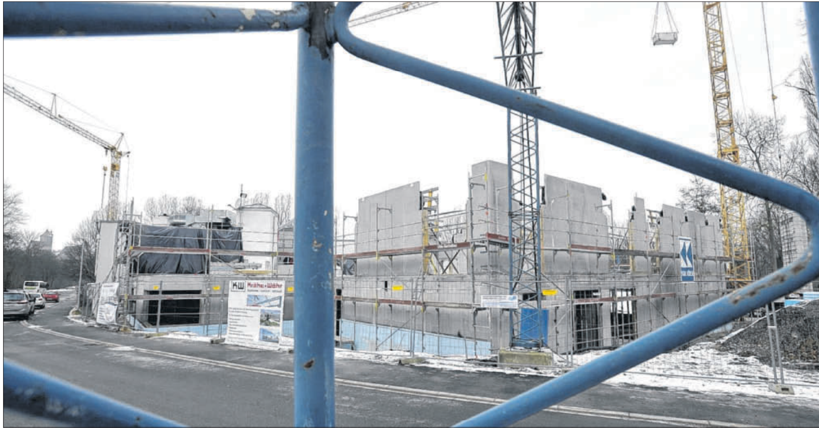
Die Baustelle des Fitkom in der Jahnstraße. Das Erdgeschoss ist fast fertig. Die Eröffnung ist für den Herbst geplant.
