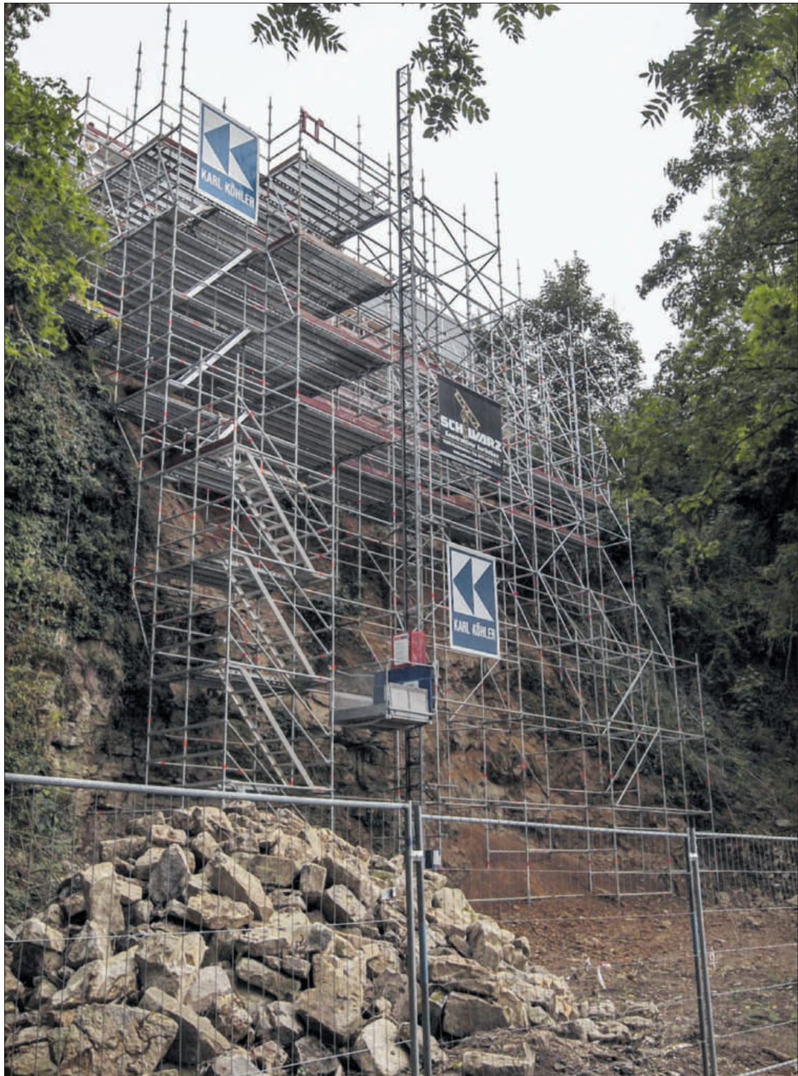
Ein Gerüst bietet den Arbeitern Zugang zu dem abgerutschten Hang beim Paul-Gerhard-Haus in Besigheim. Vorerst wird mit Kosten von 214 000 Euro für die Sanierung gerechnet.
