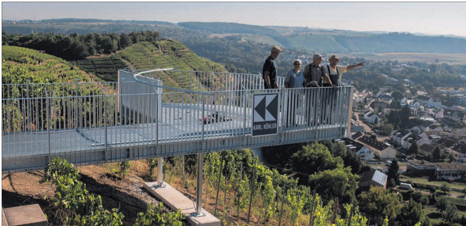
Arbeiter einer Baufirma aus Besigheim montieren in diesen Tagen ein großes Stahlgerüst auf dem Niedernberg beim oberen Panoramaweg. Es dient künftig als Aussichtskanzel und soll den Niedernberg touristisch aufwerten. Die Kanzel steht oberhalb der Himmelsleiter, deren Einstieg an der Enz ist. Über einen Durchlass führt die steile Naturstiegtreppe auf 400 Stufen hoch bis zum Panoramaweg, wo Touristen und Ausflügler künftig die Aussicht auf Besigheim und die Weinberge ringsum genießen können. Foto: Martin Kalb
