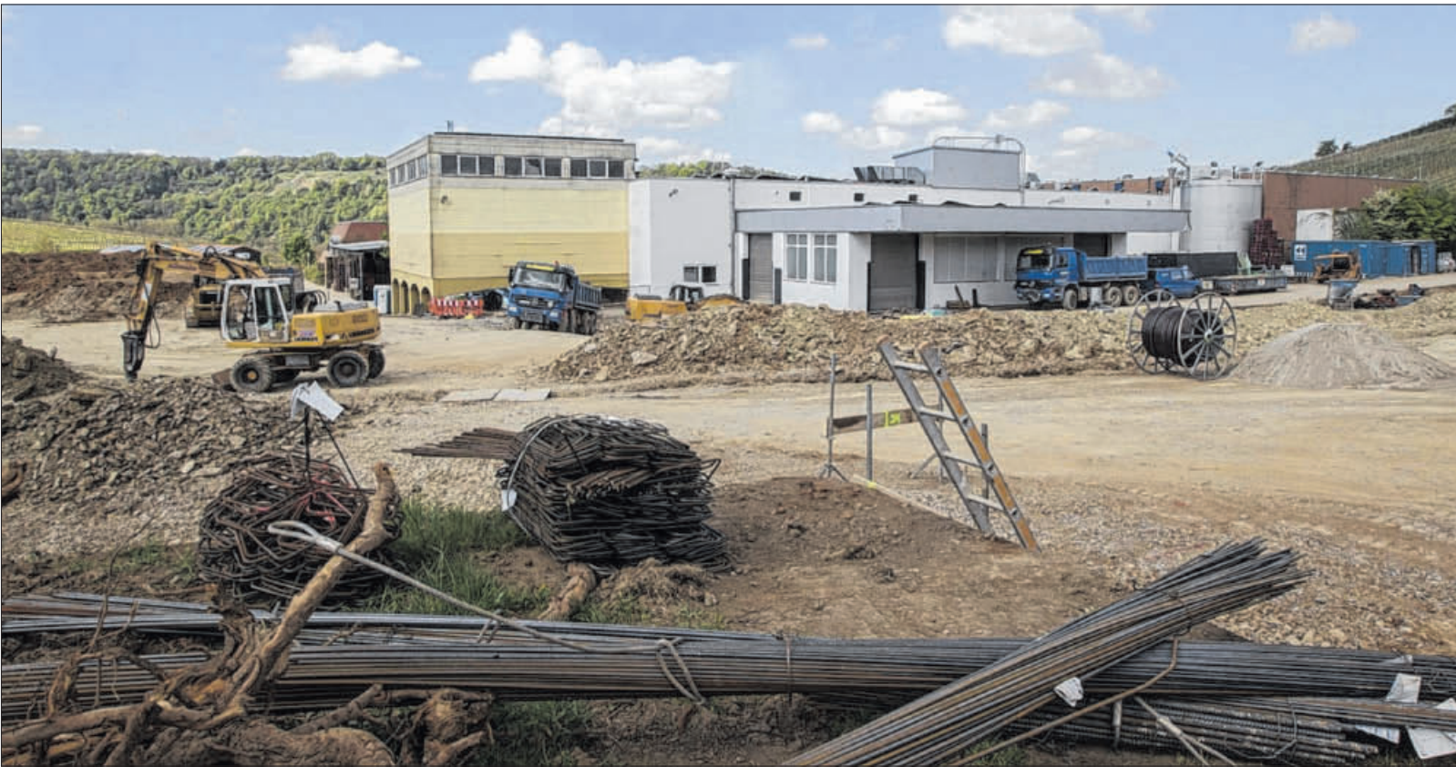
Ein ganzer Haufen Erde wurde schon bewegt: Entlang der Landesstraße entsteht vor der Felsengartenkellerei ein großer Parkplatz. Seitlich, zur Wohnbebauung hin, wird die Genossenschaft ein Flaschenlager bauen und hinter dem Gebäude eine Halle für Gerätschaften.
