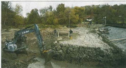
Am Bissinger Wehr (rechts) wird eine Wasserschnecke eingebaut. Dazu wurde die Enz vollständig über den Mühlkanal umgeleitet.
