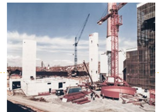
Rauchgasentschwefelungsanlage des Kohlekraftwerks Walheim, 1986
