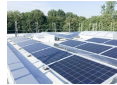
Unsere eigene PV-Anlage Auf unserer Magazinhalle erzeugen wir nachhaltigen Ökostrom.
